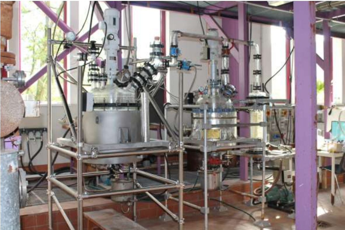
Foto 40: Vista de las dependencias, instalaciones y laboratorios de empresa K-UTEC en Alemania
